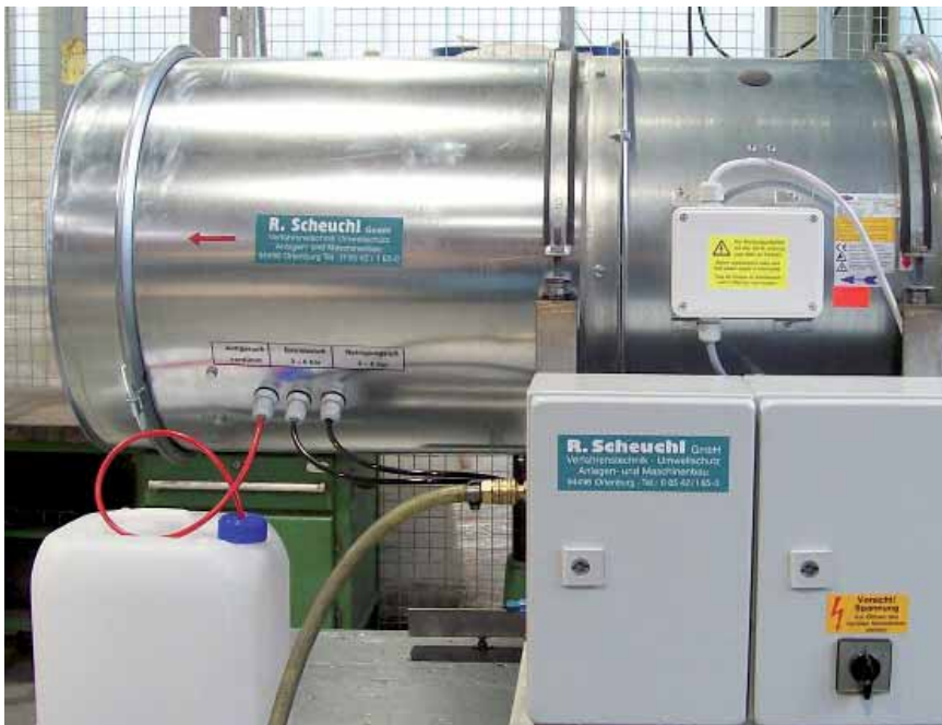
Bild 3: Ventilatorsystem mit Steuerung zur Behandlung diffuser Gerüche
