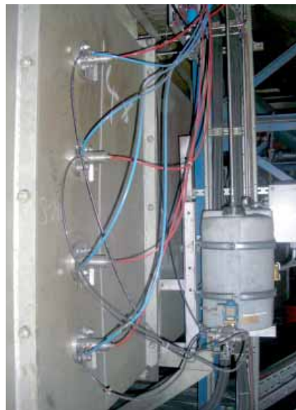
Bild 2: Eindüsung der Mikroemulsion in den Abluftkanal
