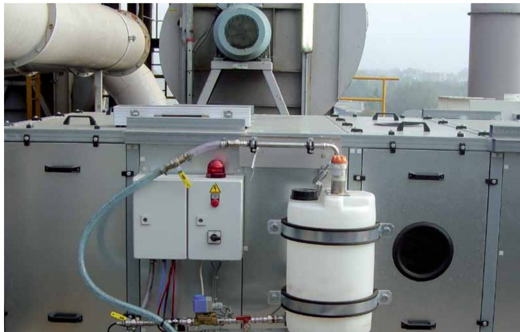
Anlage zur Geruchsbehandlung vor dem Einbau: Durch die Nachrüstung mit dieser speziell entwickelten Anlage können Geruchseinheiten in der Abluft drastisch gesenkt werden. Quelle: SKH
