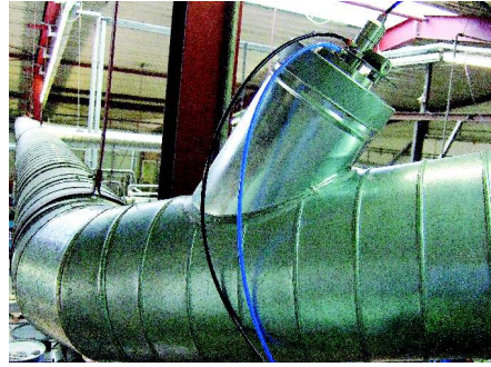
Bild 2: Eindüsanlage im Abluftkanal eines Kunststoff verarbeitenden Betriebes
